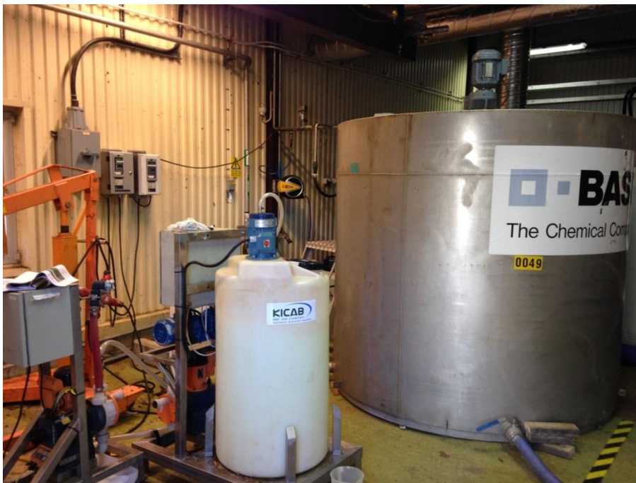
Bild nr 1: Doseringsanläggning
