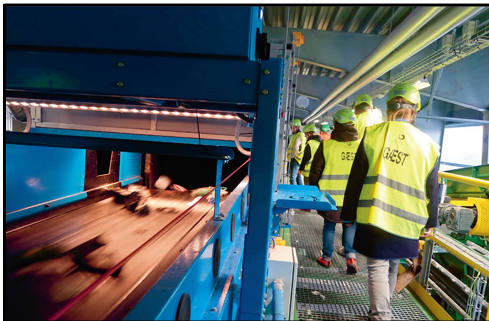
Plastsorteringsanlæg, hos Reno Nord i Aalborg, Danmark
