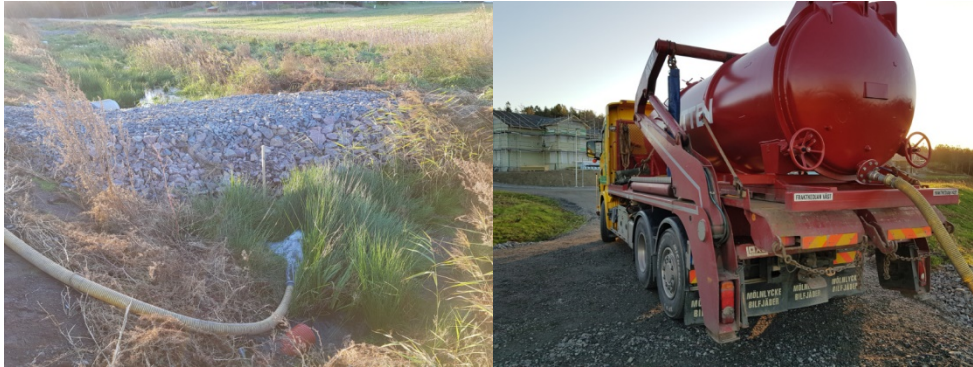
Figur 4. Utsläpp av vatten till anläggningens A-del. Hela cisternvolymen på 9m 3 tömdes ut på 15 minuter. Foto: IVL.
